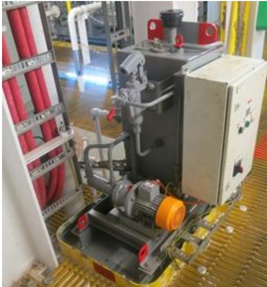
Figura 15 - Bomba de Dreno
