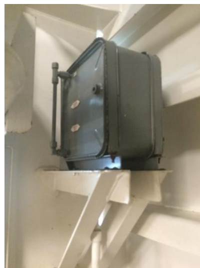
Figura 17 - Tanque para a Lubrificação das Bombas Hidráulicas
