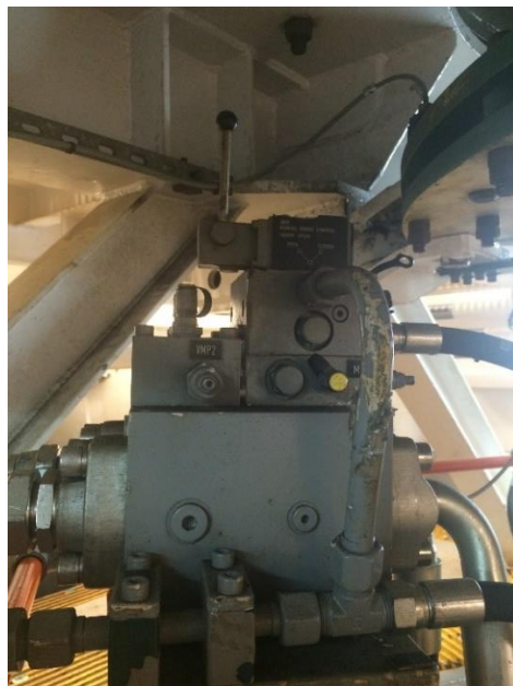
Figura 11 - Bloco de Comando Hidráulico
