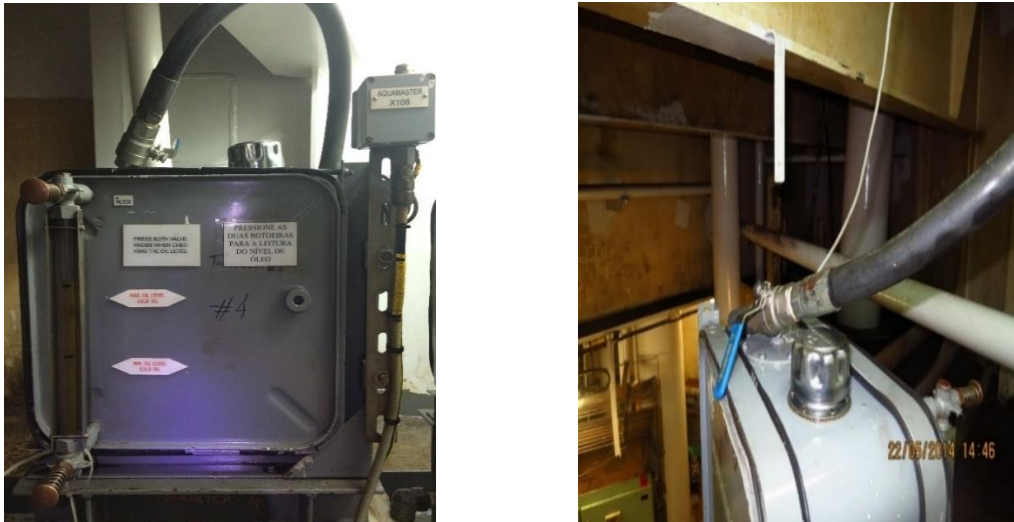
Figura 19 - Tanque de Gravidade
