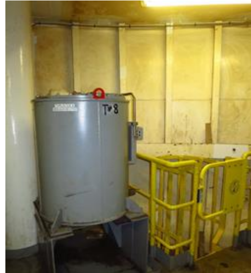
Figura 16 - Tanque de Expansão de Óleo
