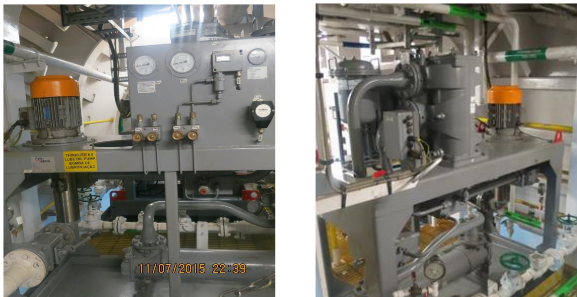
Figura 13 - Sistema de Óleo Lubrificante
